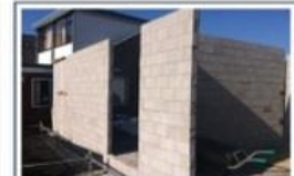
Metselwerk - Vuilwerk - buiten
