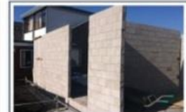
Metselwerk - Vuilwerk - buiten
